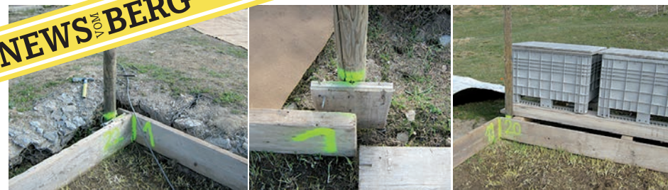
Eisfeldbau: Die Gerüstbretter werden mit System in der richtigen Reihenfolge, Boxen für die Curlingsteine und die Eisstöcke werden auf ein Podest montiert.
